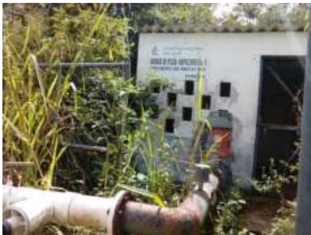
Figura 4. Abandono de estaciones de bombeo agrícola en el municipio de Hopelchén, Camp. Fuente: H. Ayuntamiento de Hopelchén.
