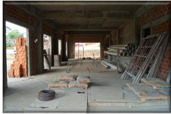
Imagen II. 4 Varillas sobresalientes del piso de cemento en el primer nivel
