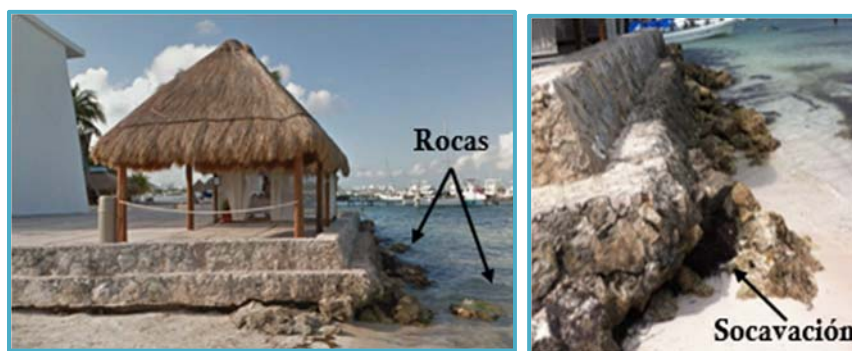
Figura II_ 2. Fotografías de la afectación por pérdida de playa en el área del proyecto.
