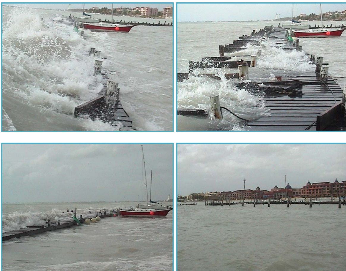
Figura II_ 4. Rompeolas en Marina Hacienda del Mar tras el paso del Huracán Iván.
