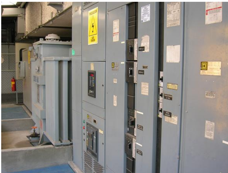
Imagen II-17. Cuarto de control eléctrico.
