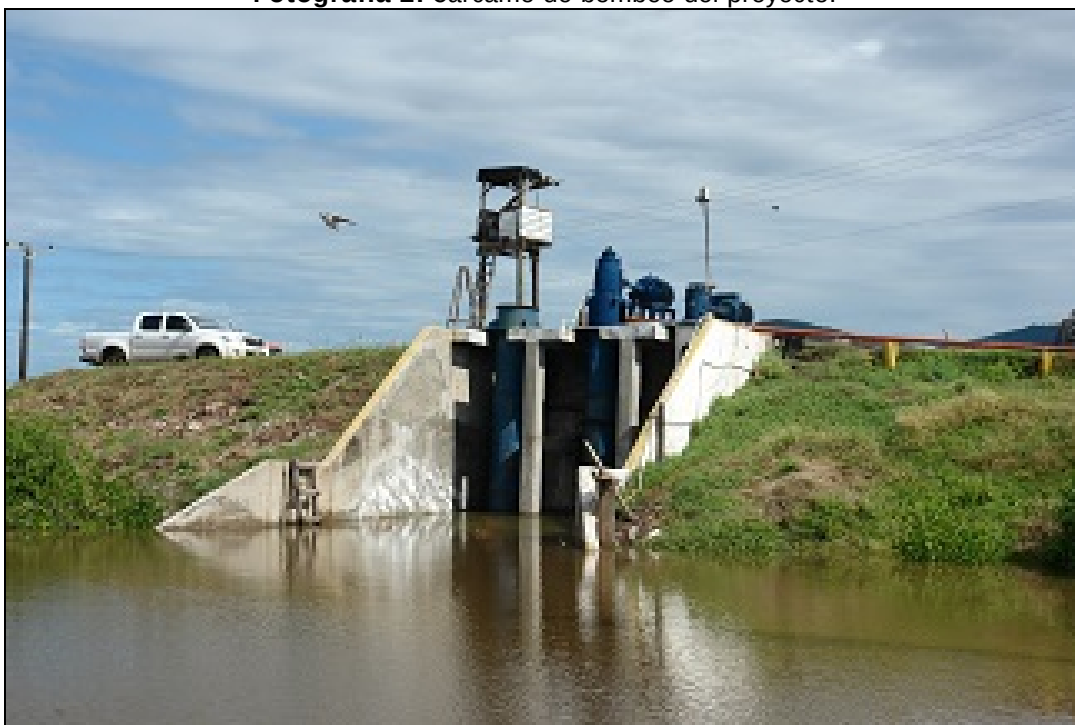
Fotografía 2. Cárcamo de bombeo del proyecto.
