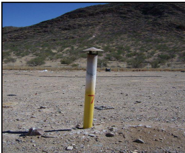
Foto No. 18 - Tubo típico para el venteo de gas
