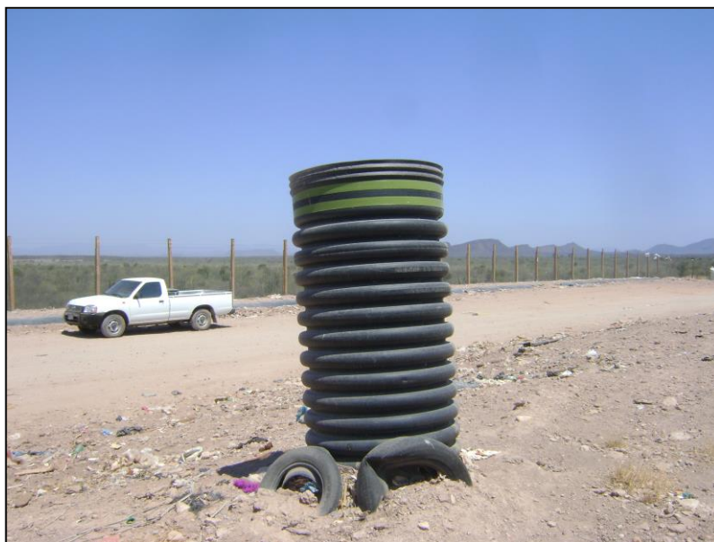
Foto No. 19.- Cárcamo de bombeo de lixiviados en la celda 1
