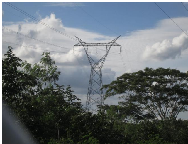
Fotografía 21 Cruce de líneas de alta tensión.
