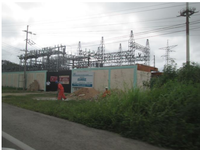
Fotografía 3 Subestación de la CFE cercana del predio.
