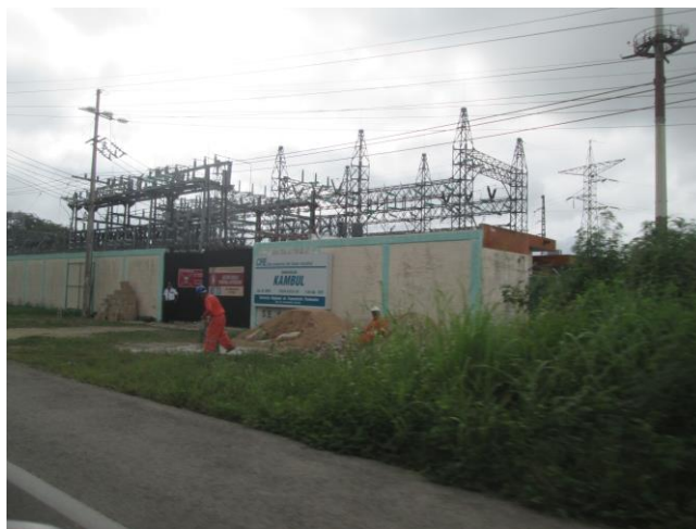
Fotografía 23 Subestación de la CFE.
