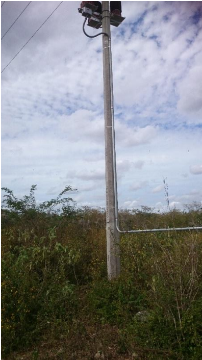
Ilustración 5 líneas de electricidad presente
