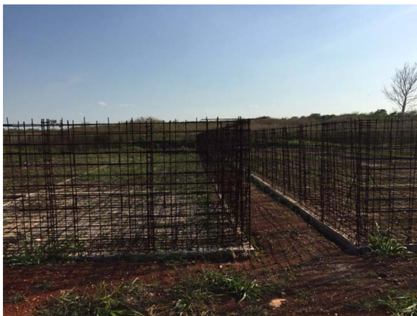
Foto 5. Infraestructura existente abandonada que fue usada para actividades pecuarias
