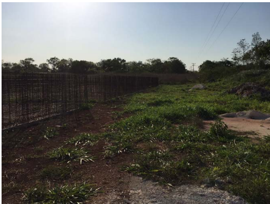
Foto 4. Infraestructura existente abandonada que fue usada para actividades pecuarias
