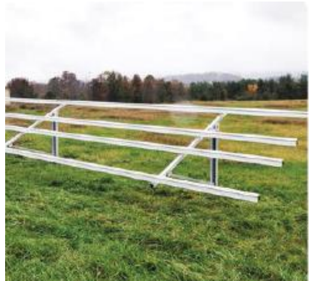
Soportes de los paneles fotovoltaicos
