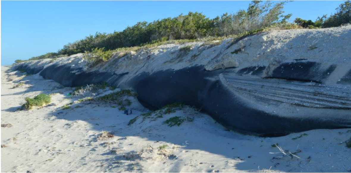
Figura 5: Tubo geotextil rasgado identificado en zona crítica.
