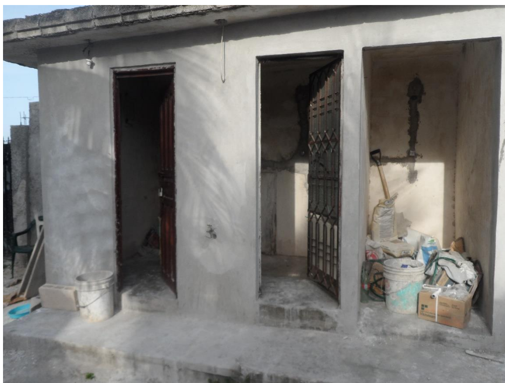
Fotografía 6. Baños inconclusos en el patio del predio.
