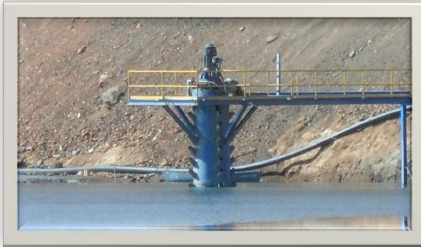
Figura II-4: Sistema de Decantación con bombeo directo de la torre de decantación.
