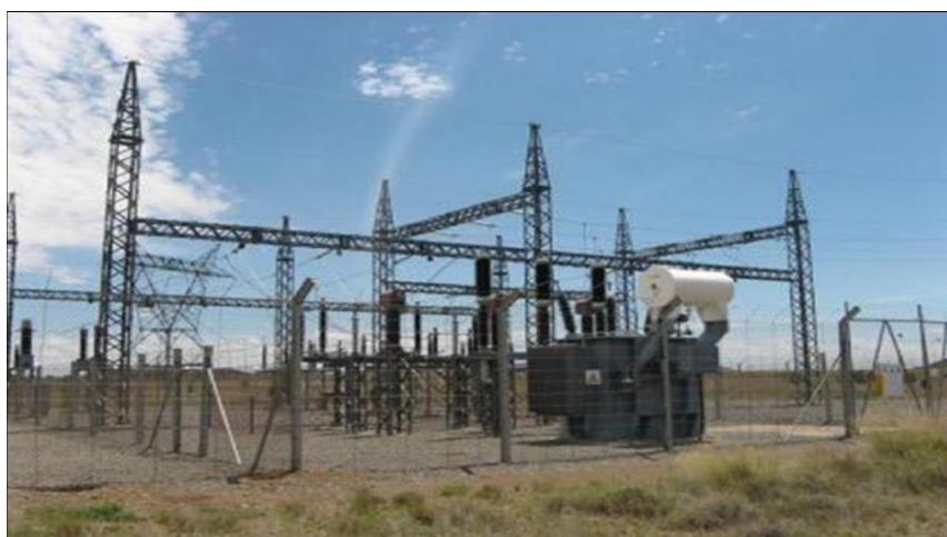
Figura. Subestación elevación 34.5/ 230kV
