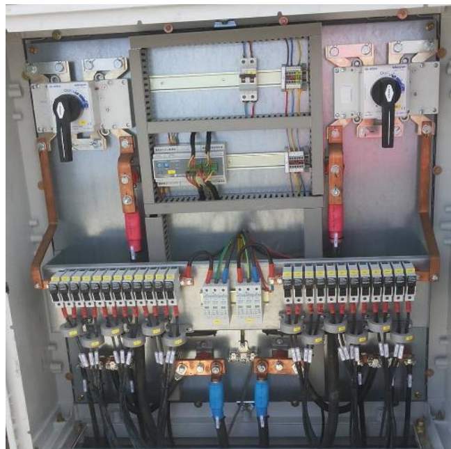
Fig. 19. Armario de protecciones (ADP's)
