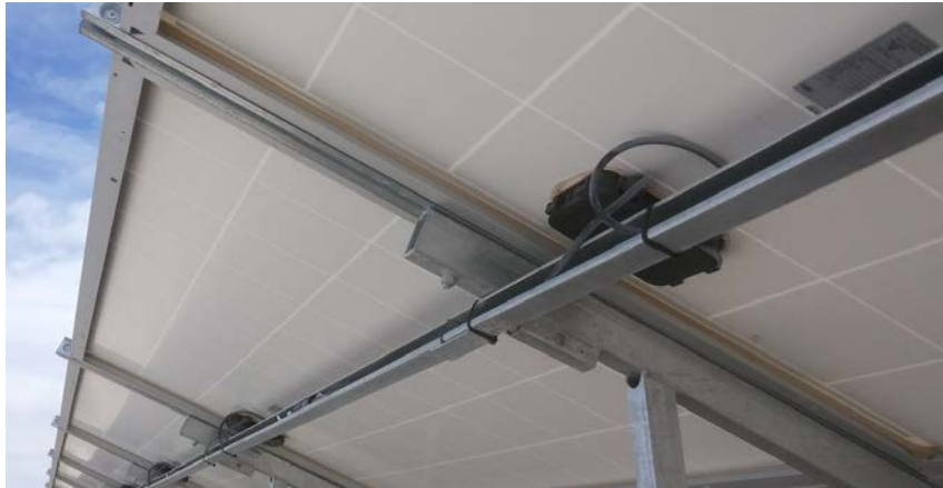
Fig. 22. Cableado de panel
