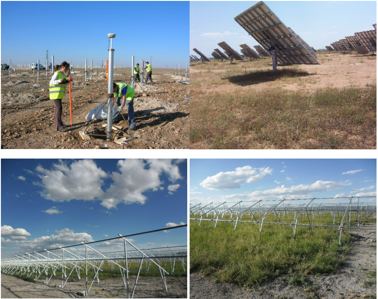
Fig. 73. Infraestructura de anclaje para el área de paneles solares, que se tiene en otros huertos solares.
