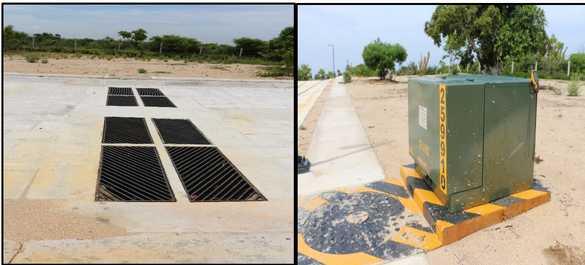
Red de drenaje de las aguas pluviales y registro para el abastecimiento de la Luz Residencial y pública en el Residencial El Origen
