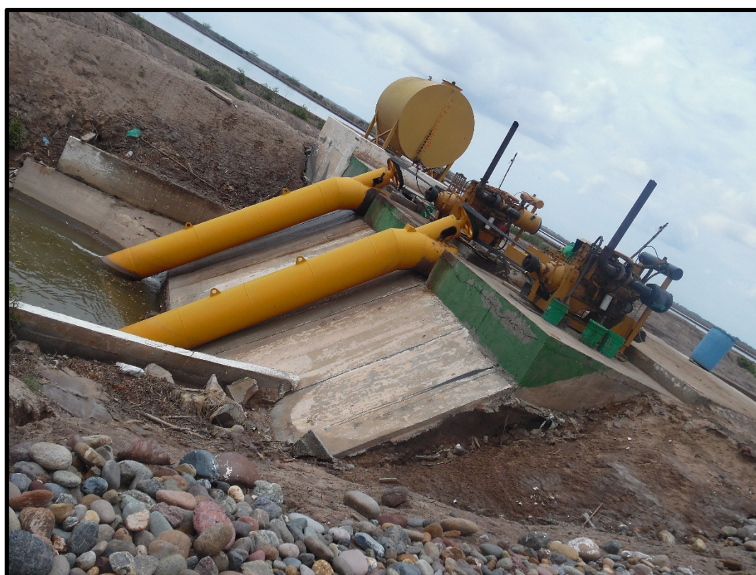
Figura II.2 Estación de bombeo de la granja Sociedad Cooperativa Acuícola Aguilasocho, S. de R.L. de C.V. (Sección La Brecha)
