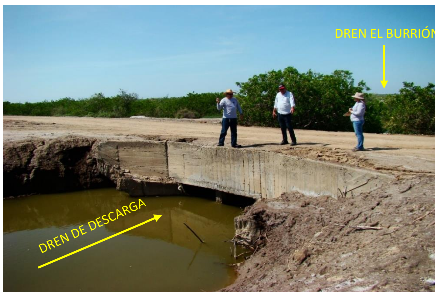
Figura 2.9 Dren de descarga.
