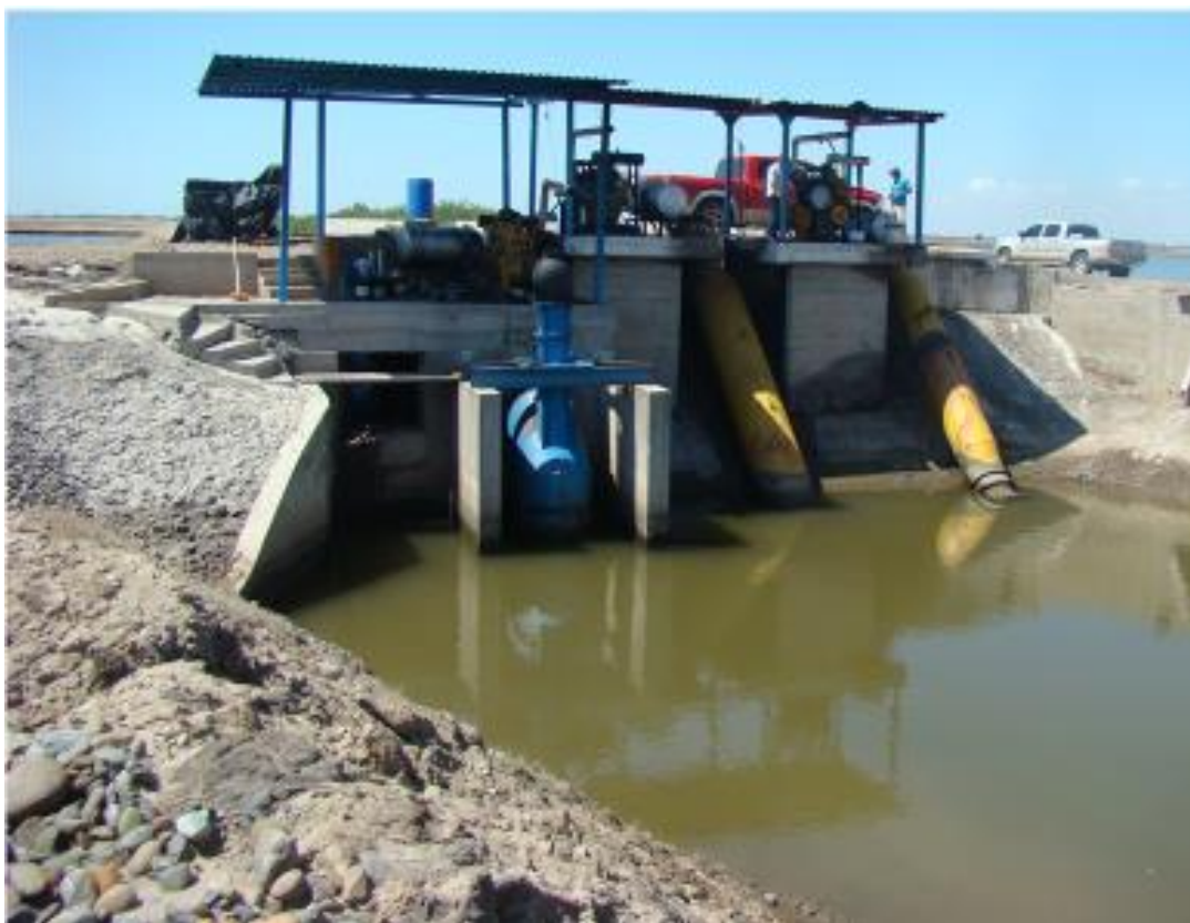
Figura 2.5 Escenario actual cárcamo de bombeo.
