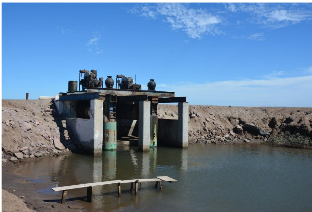
Figura II.2 Estación de bombeo de la granja JM Acuacultura antes Marion S.A. de C.V.
