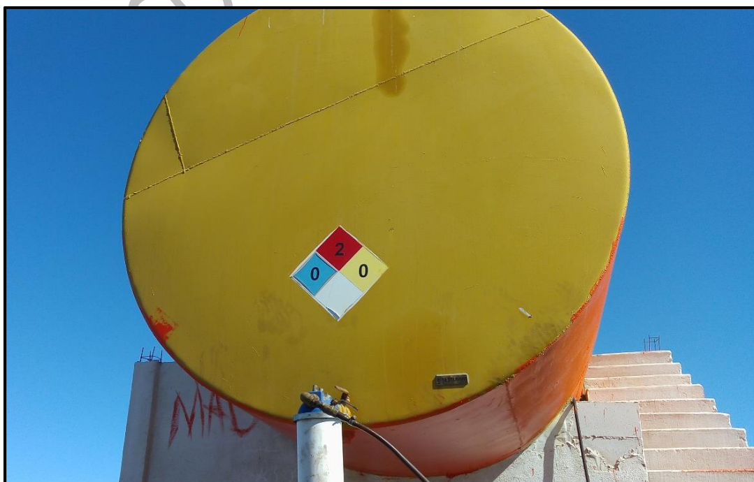
Fotografía No. 11. Tanque de diésel.
