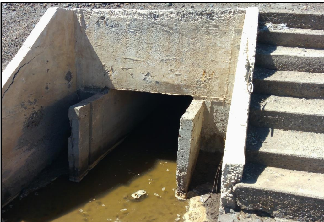
Fotografía 4. Descarga de aguas de los estanque.
