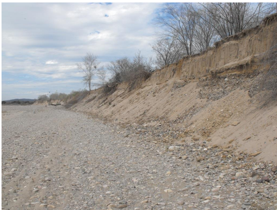
Parte donde el cauce está erosionando los taludes en las colindancias del predio.
