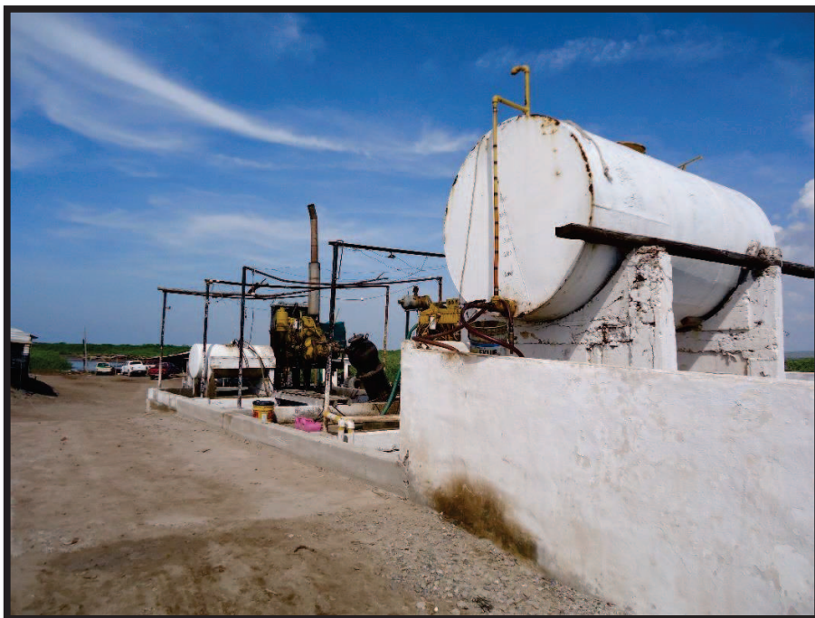
Figura II.2 Estación de bombeo de la granja Acuicola Open S.A. de C.V.
