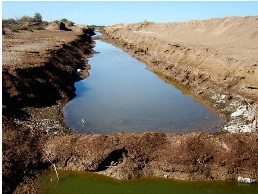
Figura 2.14 Condición del dren de descarga existente.
