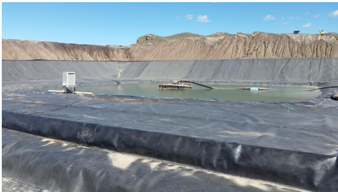
Operación actual.- Pileta en “Cerro Prieto”
