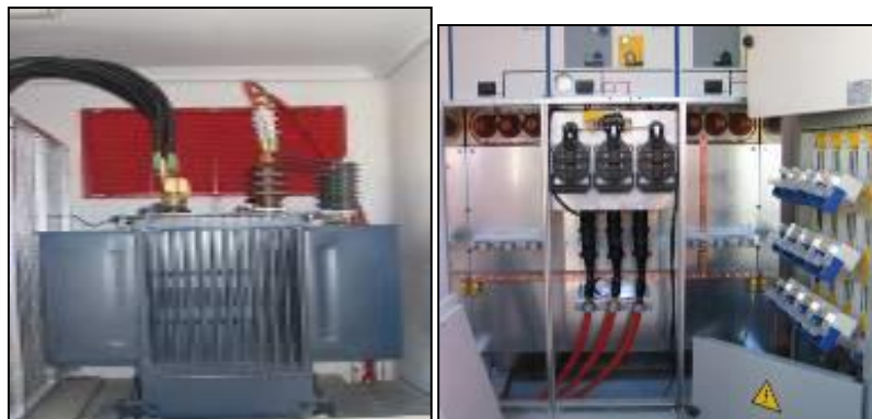
Figura II. 12 Transformador y celdas de media tensión
