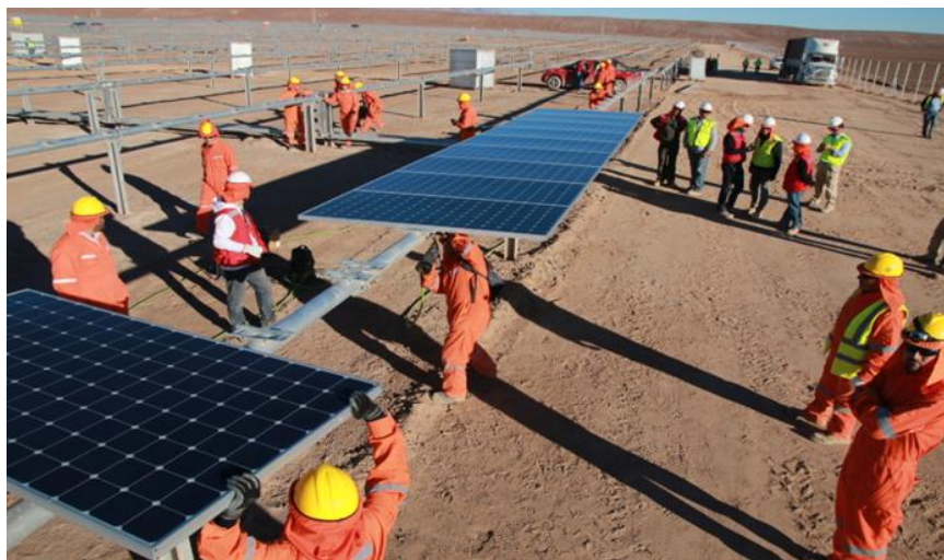
Figura II. 8 Módulos sobre los seguidores solares
