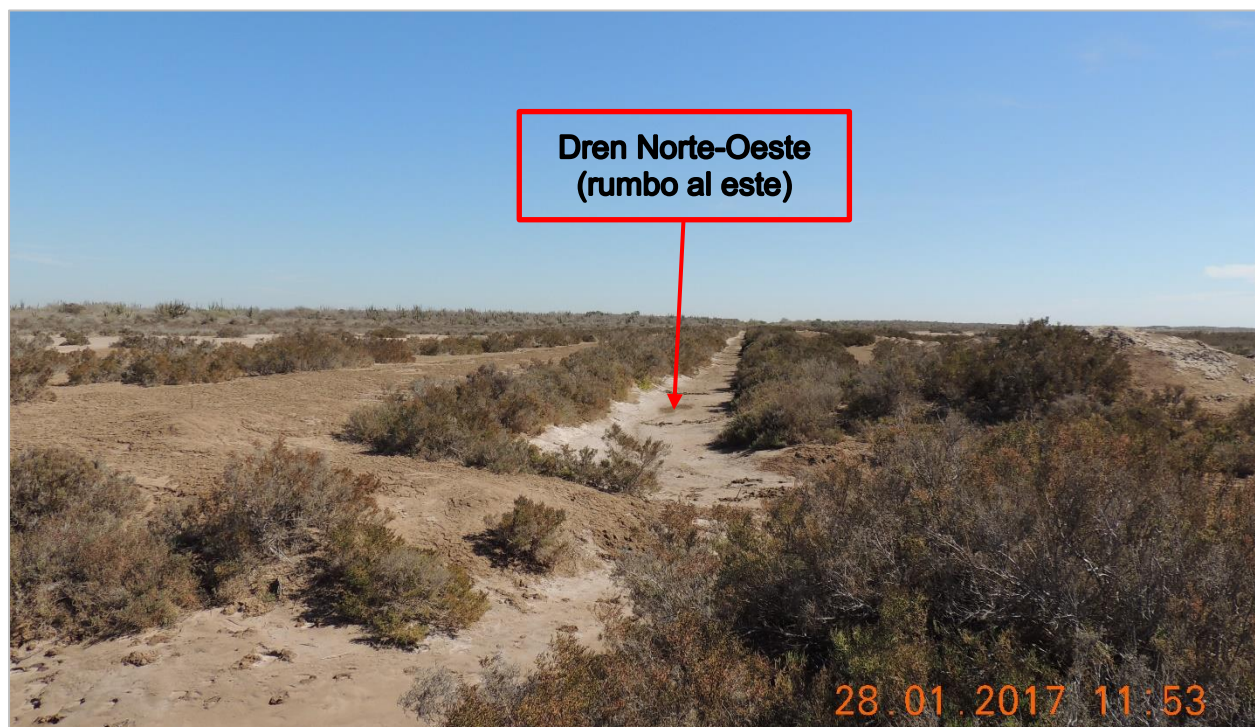
Figura 29. Imagen fotográfica que ejemplifica la condición de azolve del dren (norte-oeste) del predio donde se desarrollará el proyecto de ampliación y operación de granja productora de camarón en el municipio de Huatabampo, Sonora.
