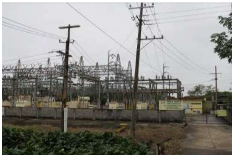
Figura II.5. En esta imagen se observa la Subestación Cárdenas I, sitio donde rematará en el marco de la Bahía.
