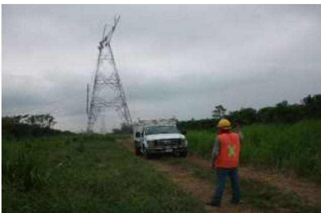
Figura II.12 Vista de un área de maniobra
