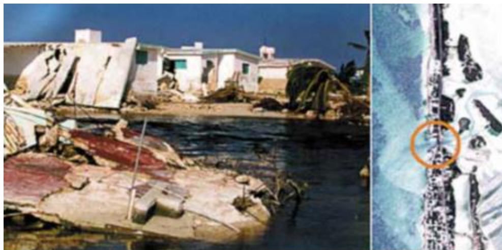
Figura IV. 33 Rupturas de la isla de barrera en el tramo San Crisanto-Dzilam de Bravo.
