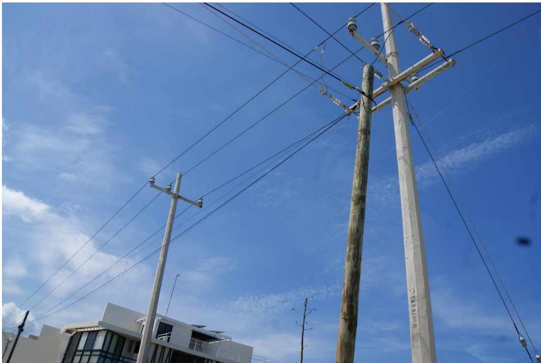
6. Infraestructura eléctrica de la zona
