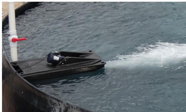
Ilustración 25.-Aireador en funcionamiento en un tanque de geomembrana.
