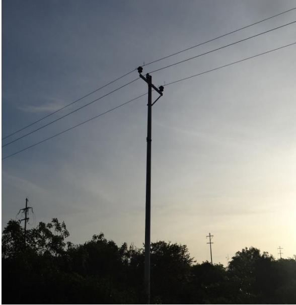
Imagen II.6. Imagen de postes de energía eléctrica existentes en las inmediaciones del sitio de pretendida ubicación del proyecto.
