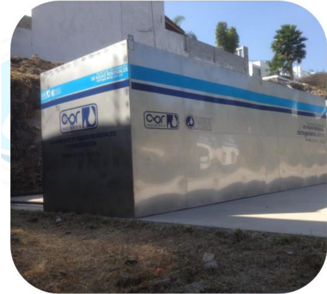
Imagen N° 1 Planta de tratamiento
