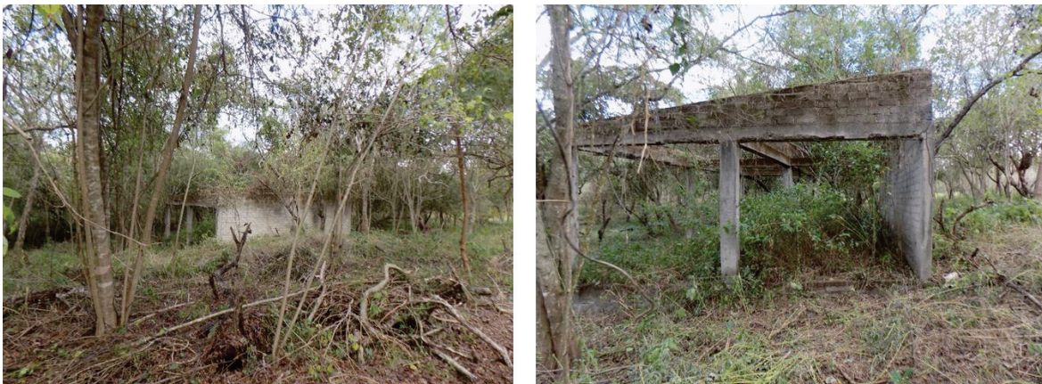
FIGURA II. 2 CUARTO SIN MUROS EN CONDICIÓN RUINOSA
