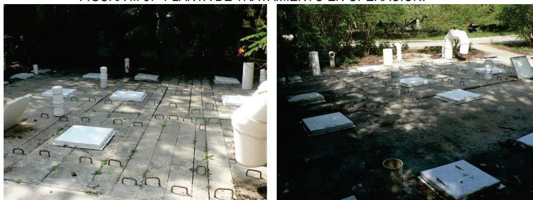
FIGURA II. 37 PLANTA DE TRATAMIENTO EN OPERACIÓN.
