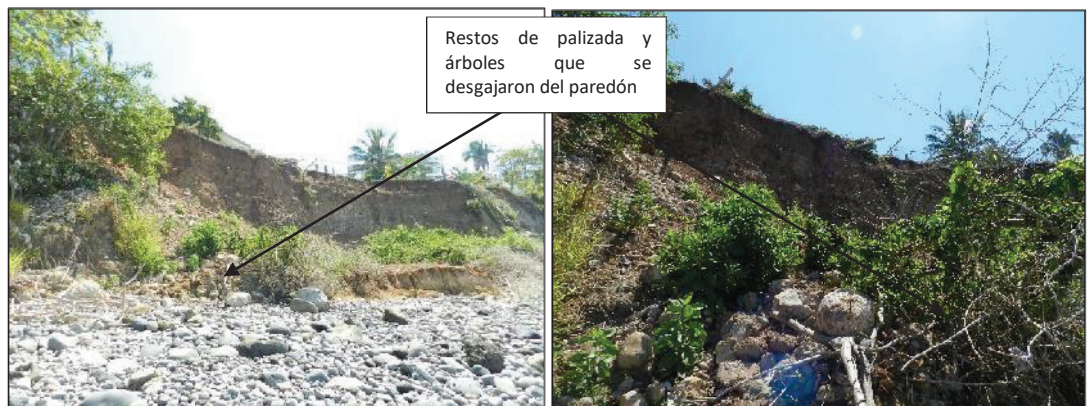
Figura V.1 Árboles caídos por efectos de erosión del suelo
