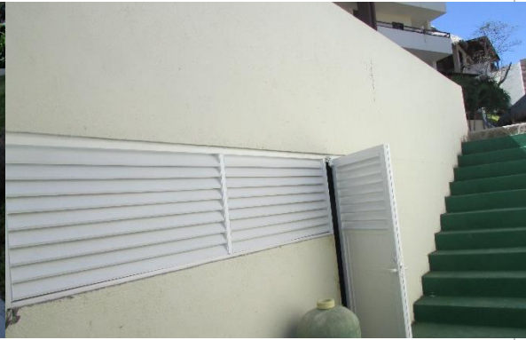
Cuarto cisterna en área de estacionamiento
