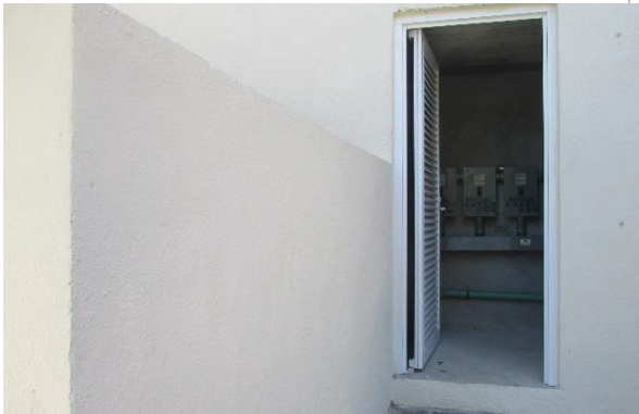
Cuarto de control eléctrico al final del edificio
