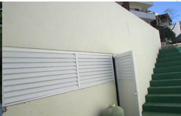
Cuarto cisterna en área de estacionamiento
