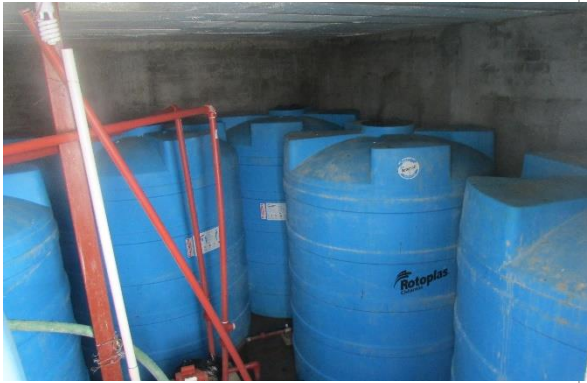
Tanques cisternas en el cuarto cisterna
