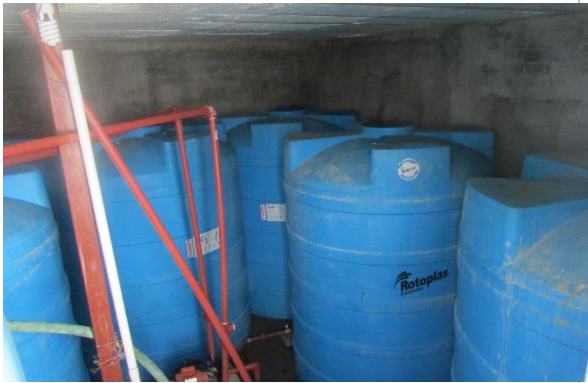
Tanques cisternas en el cuarto cisterna
