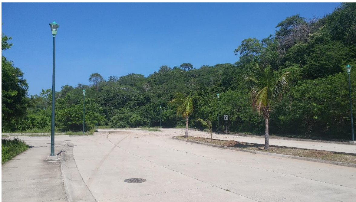
Alumbrado público, pavimento, banquetas y guarniciones y pozo de drenaje
