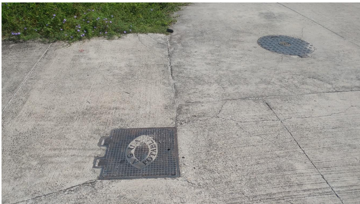
Abasto de agua potable y de energía eléctrica subterránea a pie de lote
