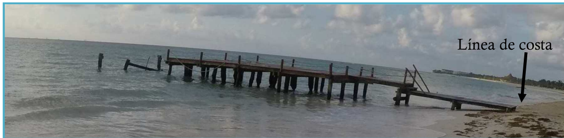
Figura II_ 13. Restos de andador de madera frente a la concesión.
