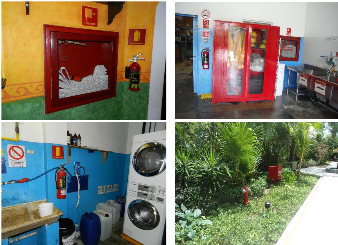
Figura 25. El hotel cuenta con equipo contra incendios, hidrantes y una red de extintores distribuidos por todas las áreas operativas y de huéspedes del hotel.
