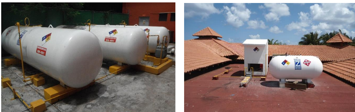
Figura 21. La empresa cuenta con cinco tanques de almacenamiento de gas L.P., tres de 5,000 L de capacidad ubicados en la zona lateral del edificio principal; así como un tanque de gas L.P. de 1,600 l ubicado sobre firme a nivel de piso al lado del camino de acceso sur, junto almacén de Stewart; y uno más ubicado en la azotea del Club de Playa en la zona suroeste del hotel con 1,600 l de capacidad.
