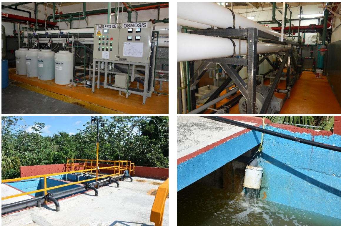
Figura 17. Se muestra la planta de ósmosis inversa que se emplea en el hotel y la planta de tratamiento de aguas residuales instalada.
