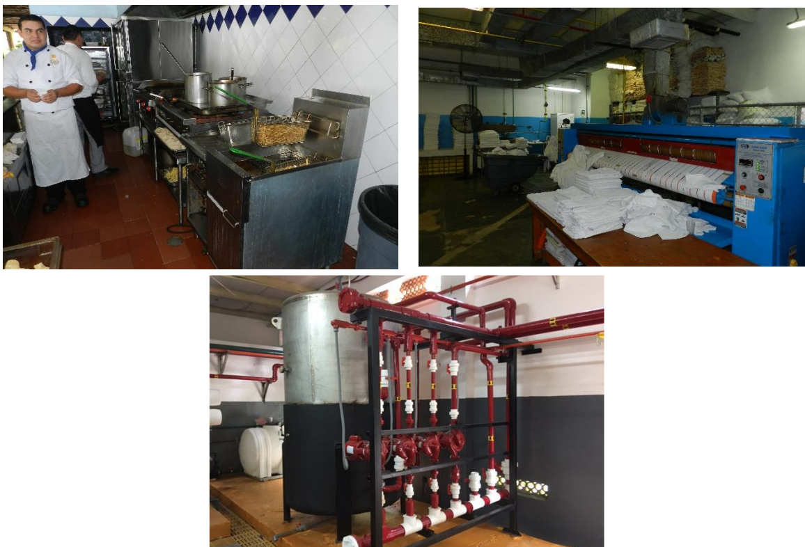
Figura 20. Equipo que opera a base de gas LP en el hotel Occidental Cozumel.
