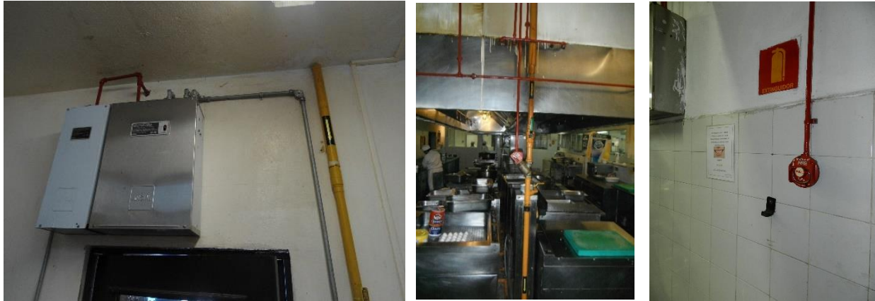
Figura 24. Las instalaciones de las cocinas principales incluyen sistemas ANSUL para la extinción automatizada de fuego y corte de gas en caso de presentarse un incendio.
