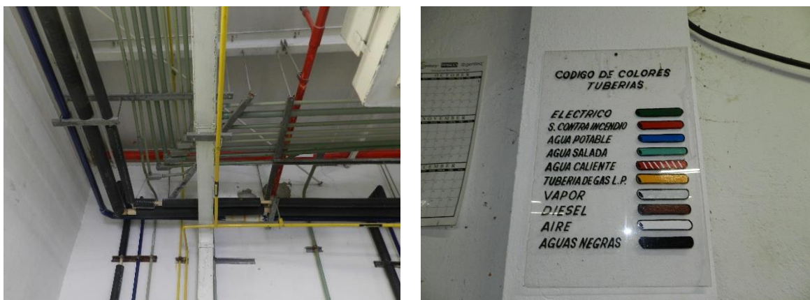
Figura 34. Las instalaciones cumplen con lo señalización de ductos conforme a la Norma NOM-026-STPS-2008.
