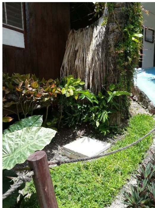
Foto 17.- Sistema de riego de jardines con efluente del biofiltro.
