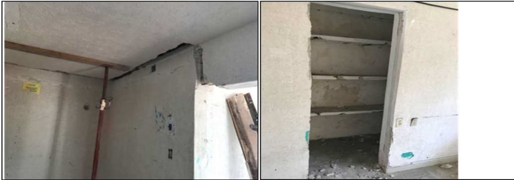
Figura. 3. Algunas de las instalaciones que requieren remodelación
