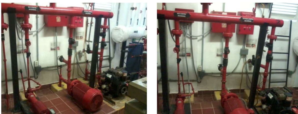
FIGURA 2.13 EQUIPO CONTRA INCENDIO
