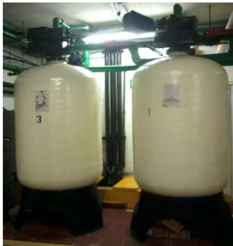
FIGURA 2.5 SUAVIZADORES DE AGUA, UBICADOS DENTRO DEL CUARTO DE MAQUÍNAS
