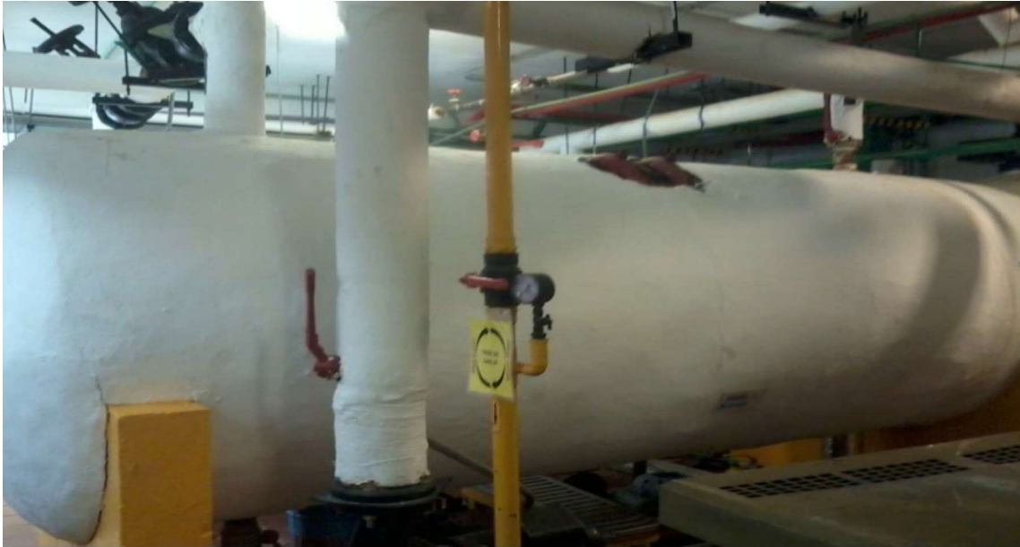
FIGURA 2.4 TANQUE DE AGUA CALIENYE DE 5000 LTS
