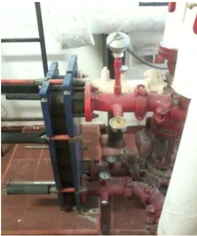
FIGURA 2.2 INTERCAMBIADOR DE CALOR
