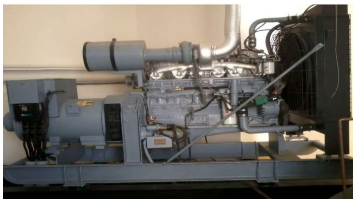
FIGURA 2.10 PLANTA DE EMERGENCIA DE CAPACIDAD DE 350 KW 220 V CON TRANSFER DE 1200 A
