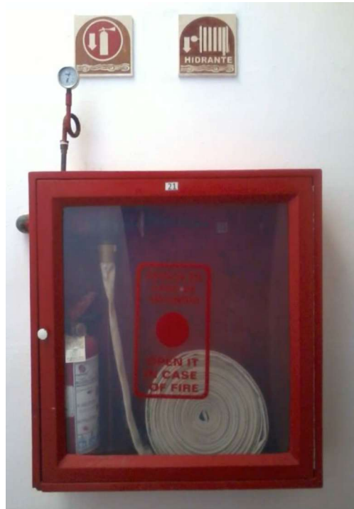
FIGURA 2.14 HIDRANTE CONTRA INCENDIO
