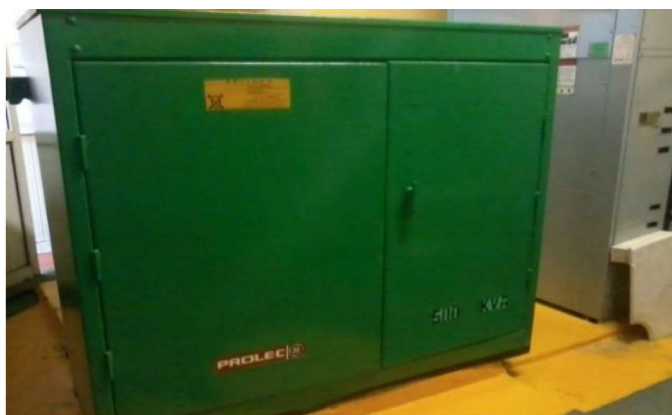
FIGURA 2.9 TRANSFORMADOR EN SUBESTACIÓN PRINCIPAL
