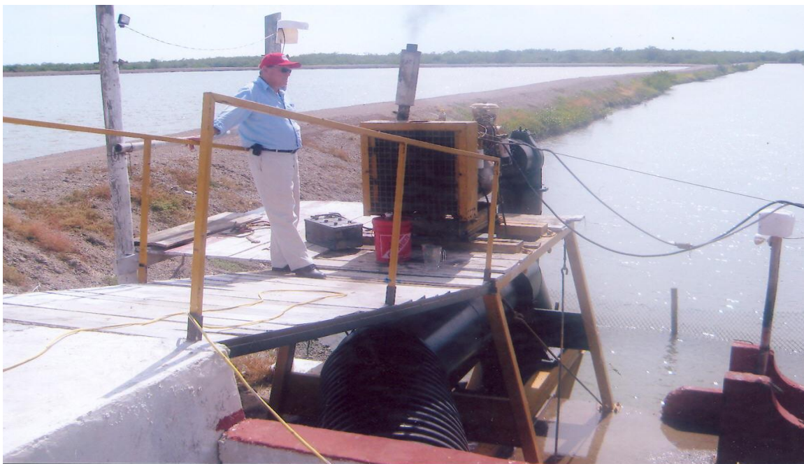
Fotografía 2. Cárcamo o estación de bombeo
