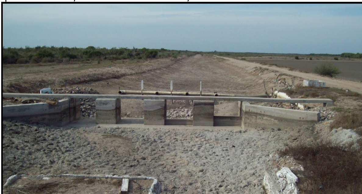
SEFA-2 instalado en la granja.
