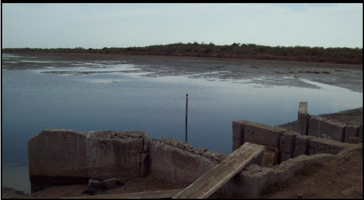
Compuertas de descarga.
