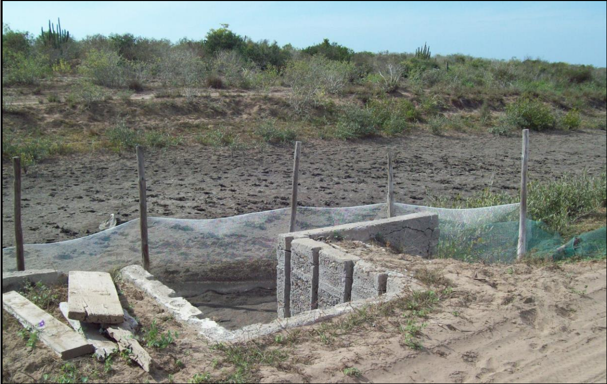
Compuertas de entrada conectadas al reservorio.
