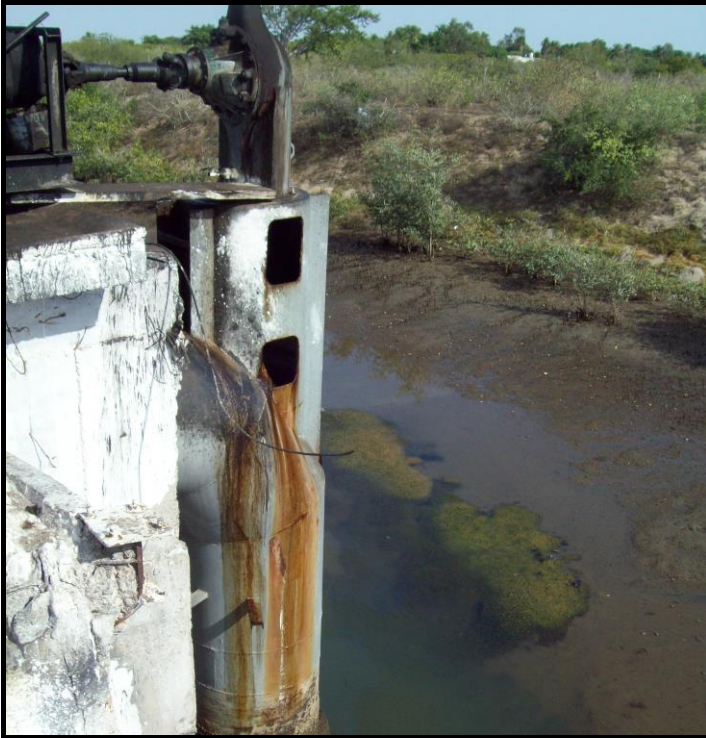
Punto de toma en el cárcamo de bombeo.
