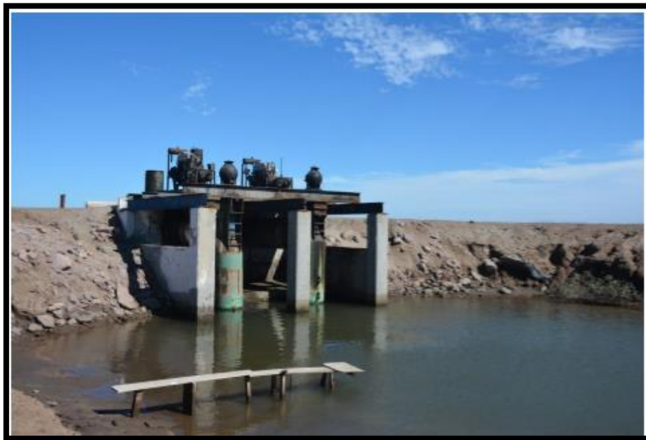
Figura II.4.- Cárcamo de bombeo de la granja JM Acuacultura.
