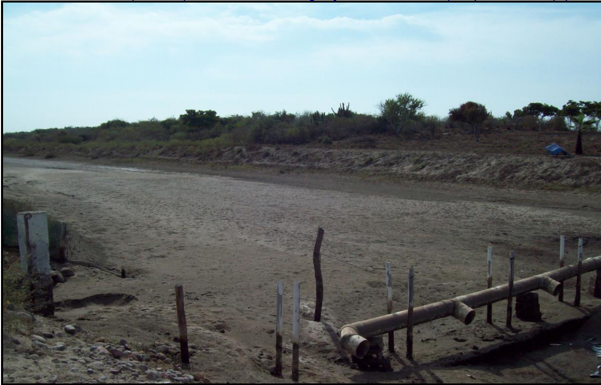
SEFA-2, ya instalado.
