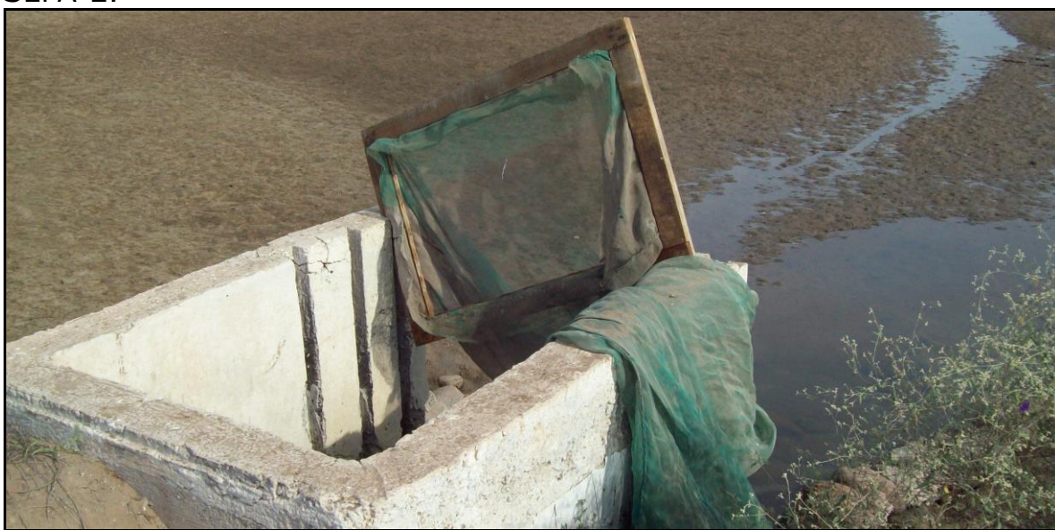
Filtro de malla mosquitera en compuerta de entrada.
