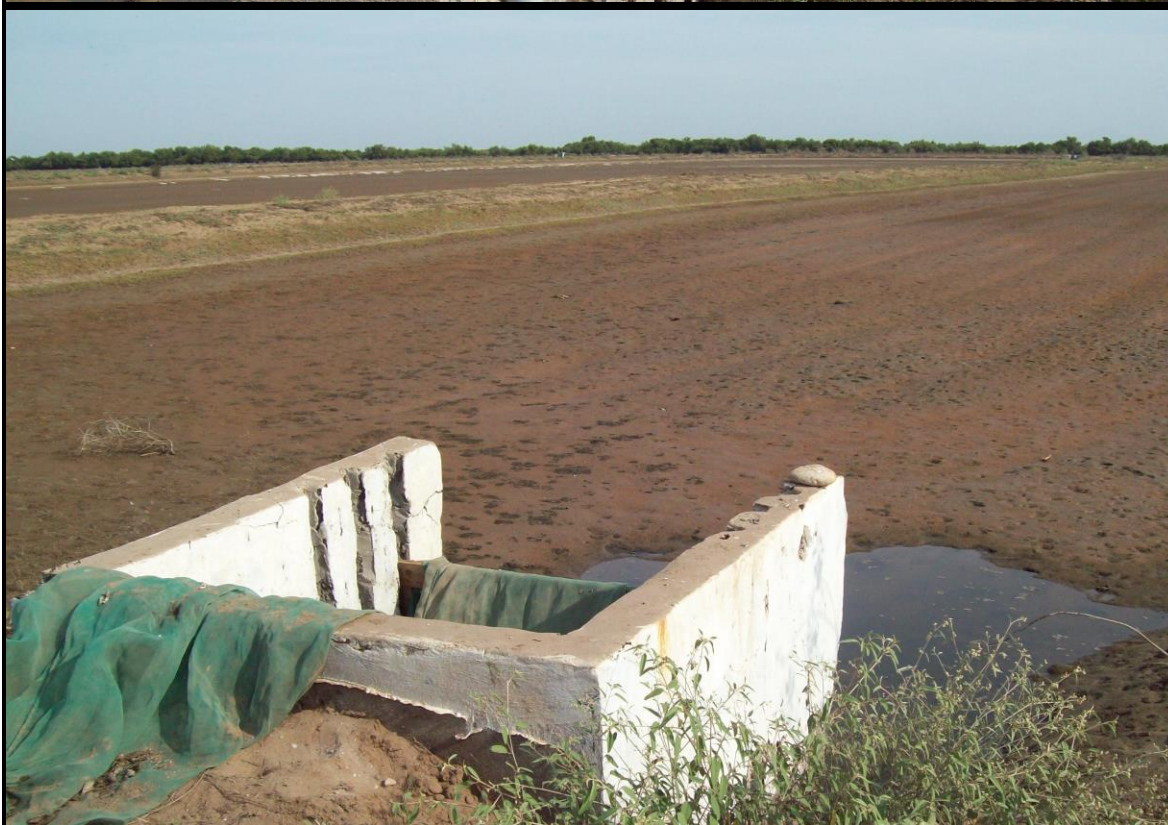
Compuertas de entrada y salida.
