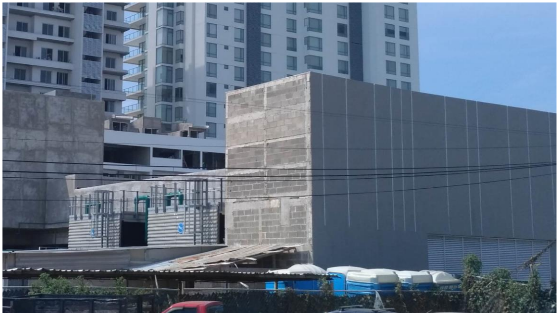
Imagen II.5 Imagen Lateral de PTAR en BAYAM Residences Acapulco.
