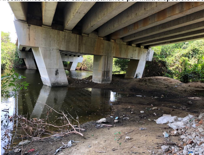
Foto 17. Afectaciones sobre el canal meándrico por mala disposición de residuos.
