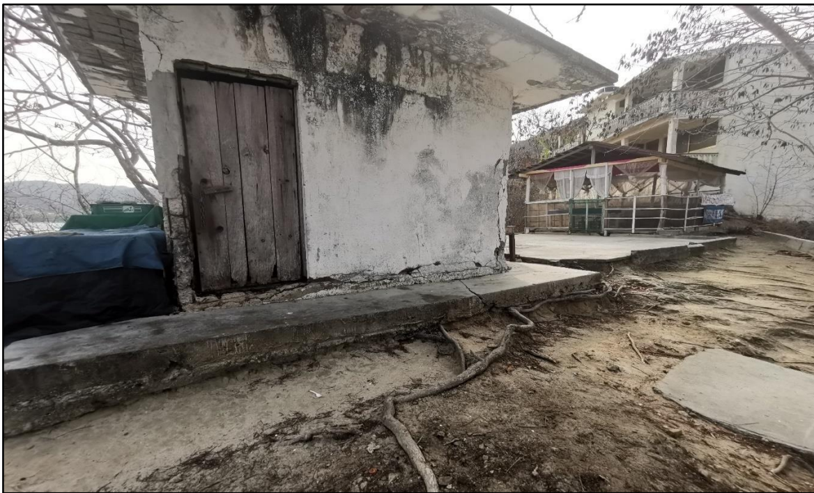
Imagen 29. Presenta las condiciones actuales del sitio sobre el que se llevará a cabo la construcción de la cabaña y que por su alto grado de deterioro resulta necesario su retiro y proyección de una nueva obra.
