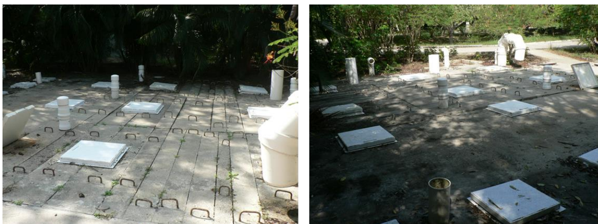
FIGURA II. 56 PLANTA DE TRATAMIENTO EN OPERACIÓN.
